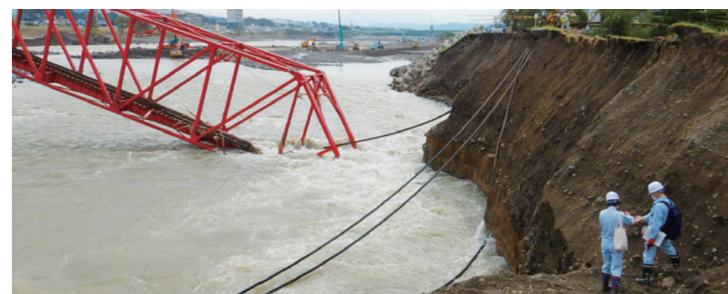
千曲川被災堤防調査
